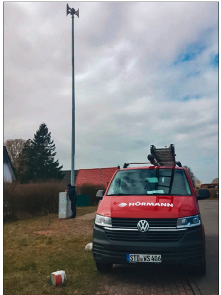
Inbetriebnahme einer elektronischen Sirene im Ortsteil Thesenvitz
